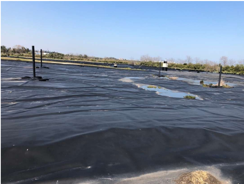
Figura 2. Telo di copertura ex discarica Rocca San Giovanni (foto sopralluogo del 27 luglio 2023)
